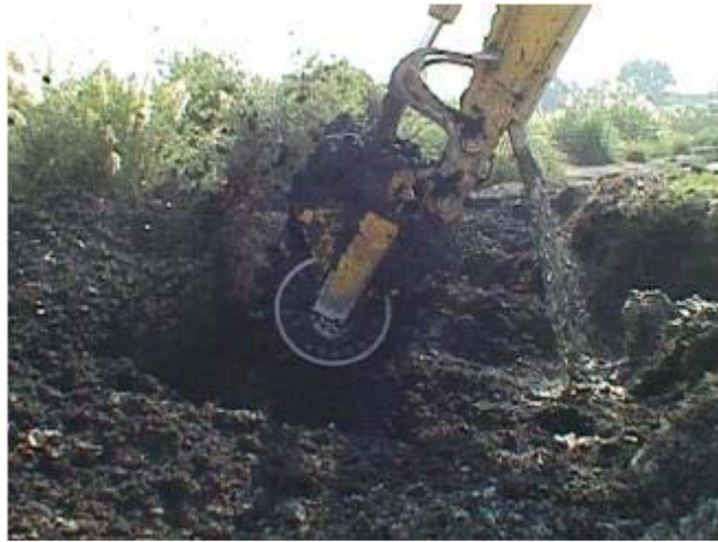
Foto 4: Estabilización/solidificación en operación continua utilizando retroexcavadora con rodillo hidráulico y reactivos mezclados con agua.
