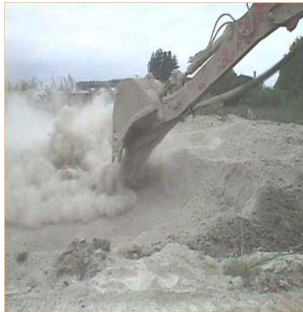
Foto 2: Aplicación de estabilización/solidificación en operación continua utilizando retroexcavadora y reactivos en seco.
